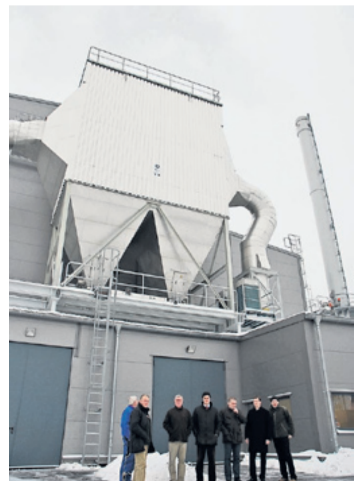
Fünf Megawatt elektrische und zehn MW thermische Leistung werden aus unbehandeltem Holz und Wasser erzeugt.
